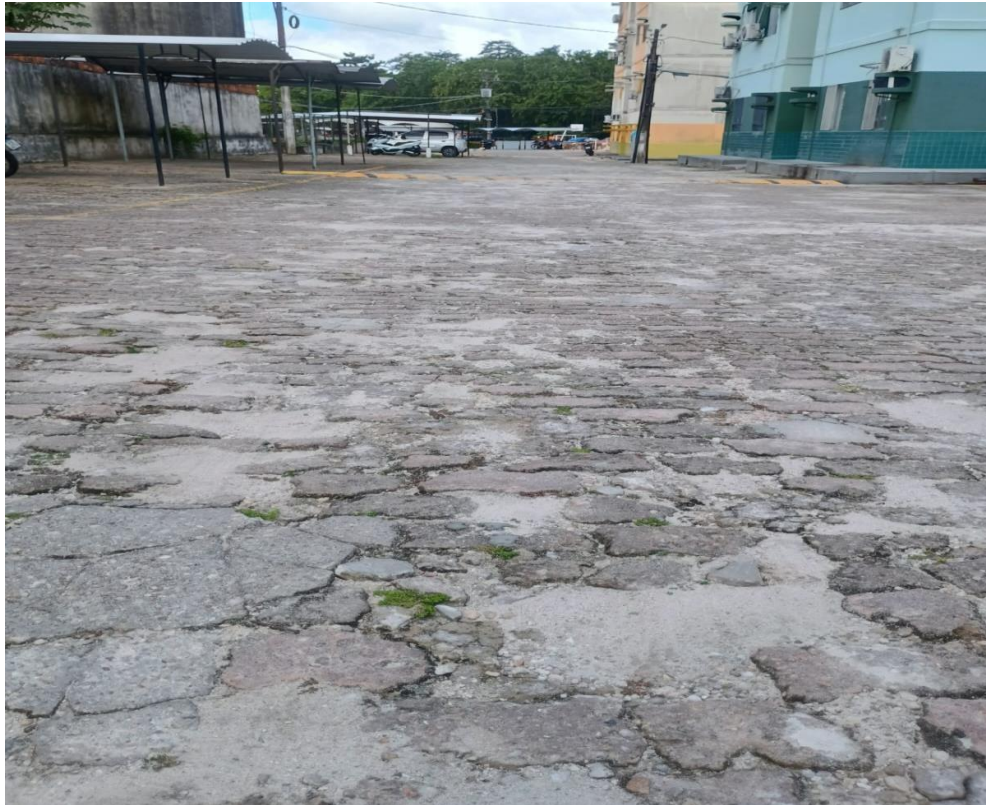
Figura 11 – Vias internas com desníveis localizados e perda de material de rejuntamento.
