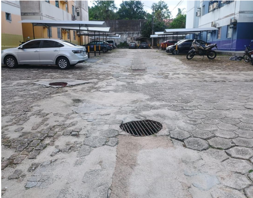
Figura 12 – Perda de material de rejuntamento e desgaste superficial das peças intertravadas
