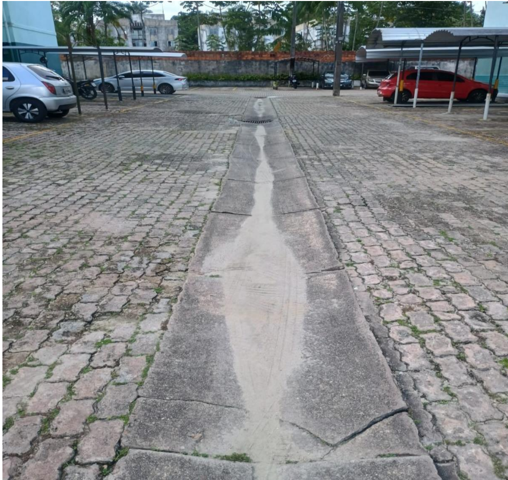
Figura 8 – Canaleta de drenagem superficial integrada ao sistema de pavimento intertravado.
