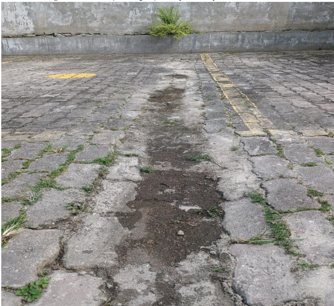
Figura 13 – Presença de vegetação nas juntas do pavimento intertravado
