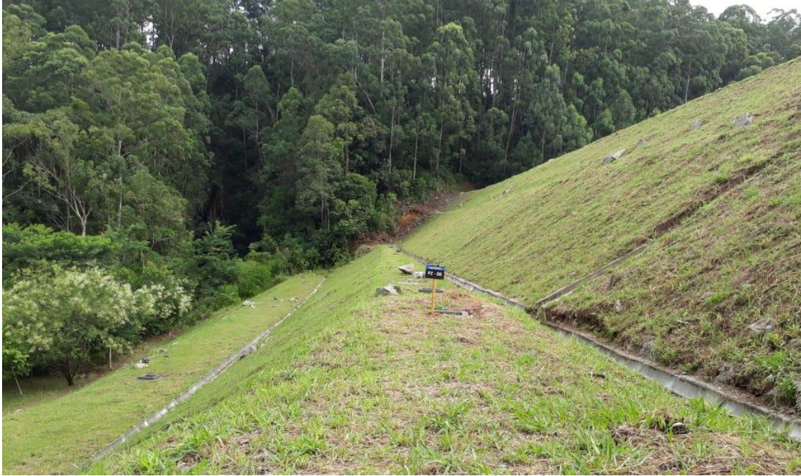
Figura 13 - Estrutura de drenagem com canaletas bem mantidas e ao fundo instrumentos de monitoramento e medição.
