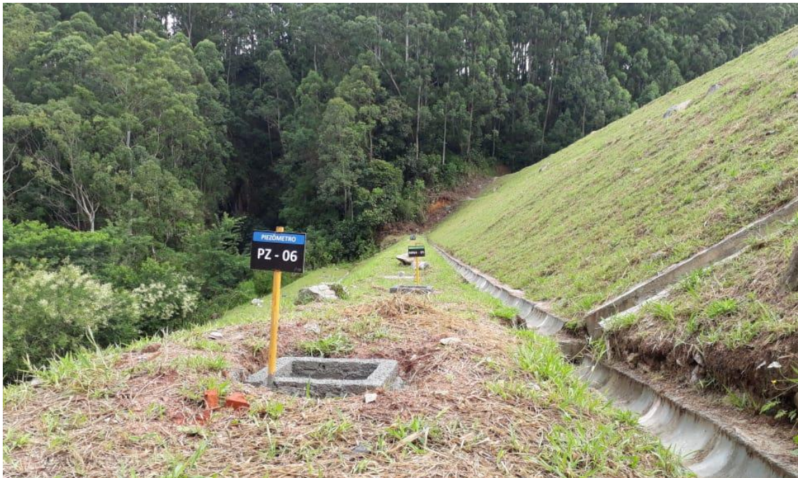
Figura 12 - Piezômetro instalado conforme instrumentação da barragem.
