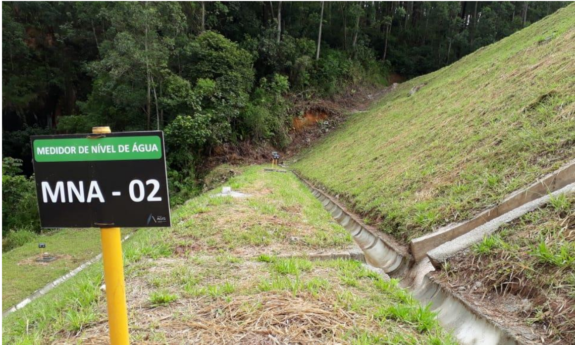
Figura 11 - Medidor de nível d'água instalado no maciço da barragem.
