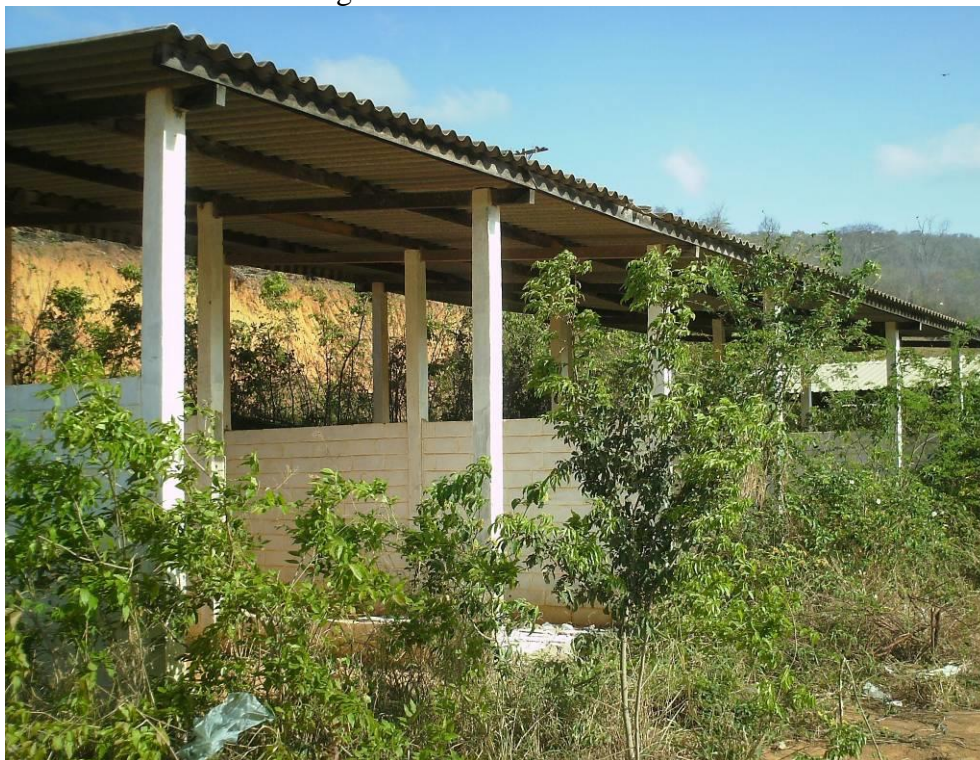
Anexo III – Usina de Triagem: Baias de acondicionamento dos resíduos
