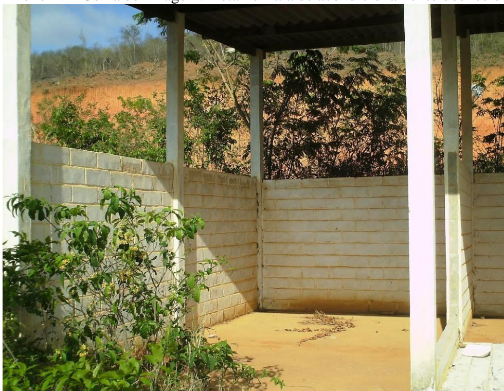
Anexo IV - Usina de Triagem: Detalhe Baia de acondicionamento dos resíduos
