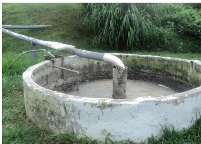
Figura 15 - Filtro da ETE
