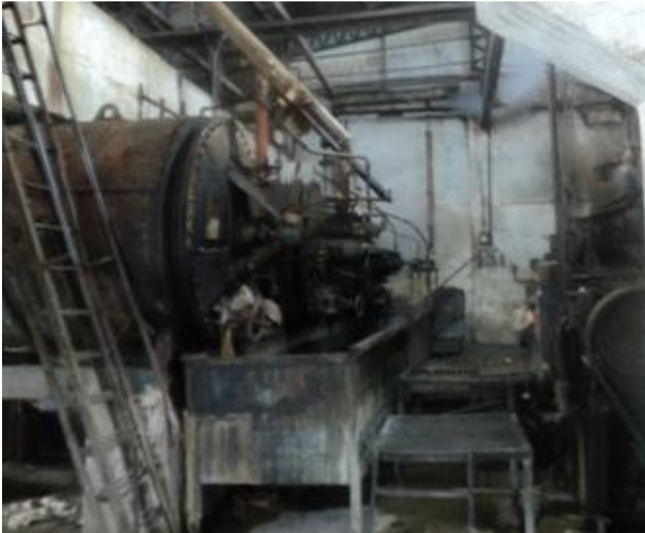
Figura 8 - Digestor e tanque na Graxaria
