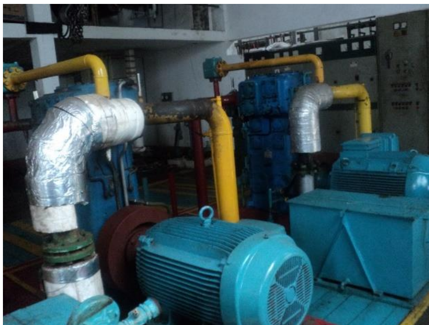
Figura 6 - Sala de máquinas do frigorífico
