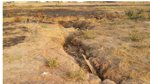
Figura 16 Trecho. Córrego do Gago. Efeito da retirada da vegetação na faixa de preservação permanente, com bordas de voçorocas ao longo dos trechos. Fonte: O Autor
