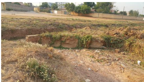
Figura 17 Trecho. Córrego Redenção. Efeito da retirada da vegetação na faixa de preservação permanente, com bordas de voçorocas ao longo dos trechos. Fonte: O Autor
