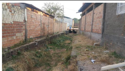
Figura 12 Trecho. Córrego Redenção. Lançamento de esgoto ao longo da calha fluvial. Fonte: O Autor
