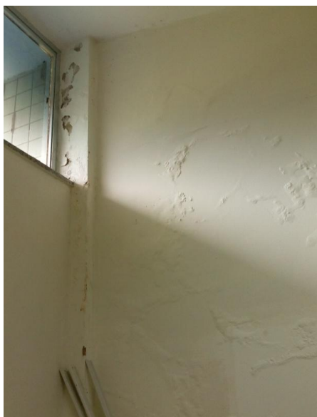
Figura 9. Infiltrações localizadas ao oeste no herbário.
