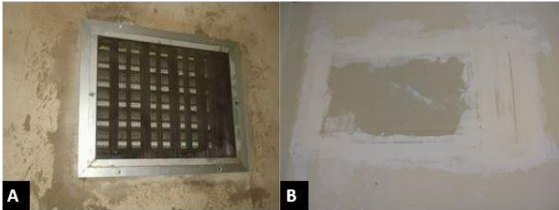
Figura 17. Antiga entrada de ar do sistema de ar condicionado (A) e hoje com preenchimento(B).
