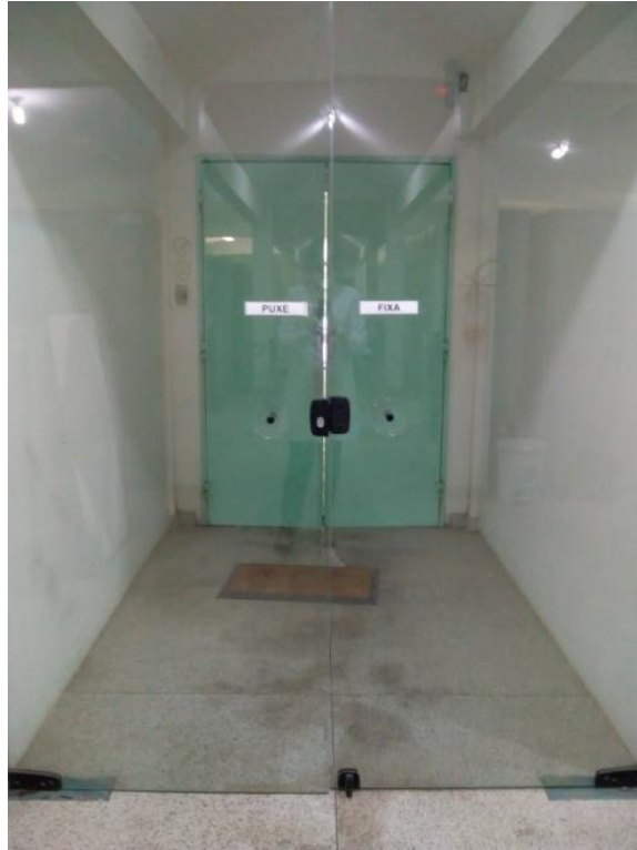
Figura 11. Porta sem vedação adequada.
