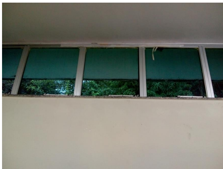
Figura 10. Janelas sem a vedação adequada.
