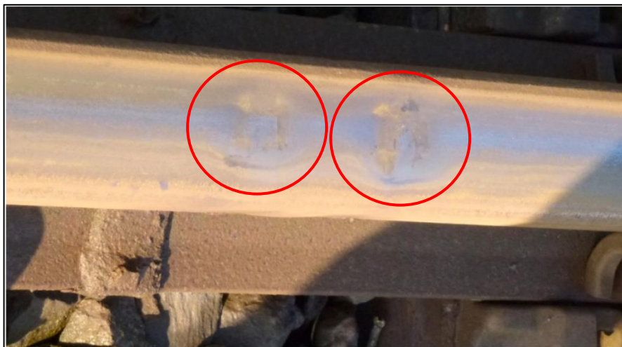
Figura 21 - Danos em ambas as zonas termicamente afetadas pelo calor de uma solda aluminotérmica.
