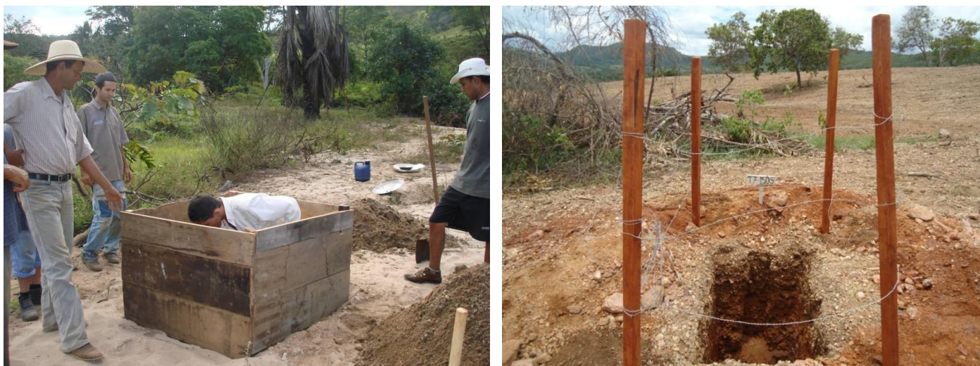
Fotos 05 e 06: Abertura e cercamento de poços exploratórios, necessários para pesquisa mineral.
