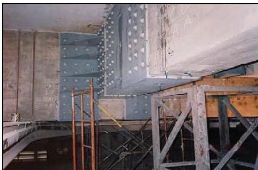
Figura 17 – Reforço com chapas de aço.
